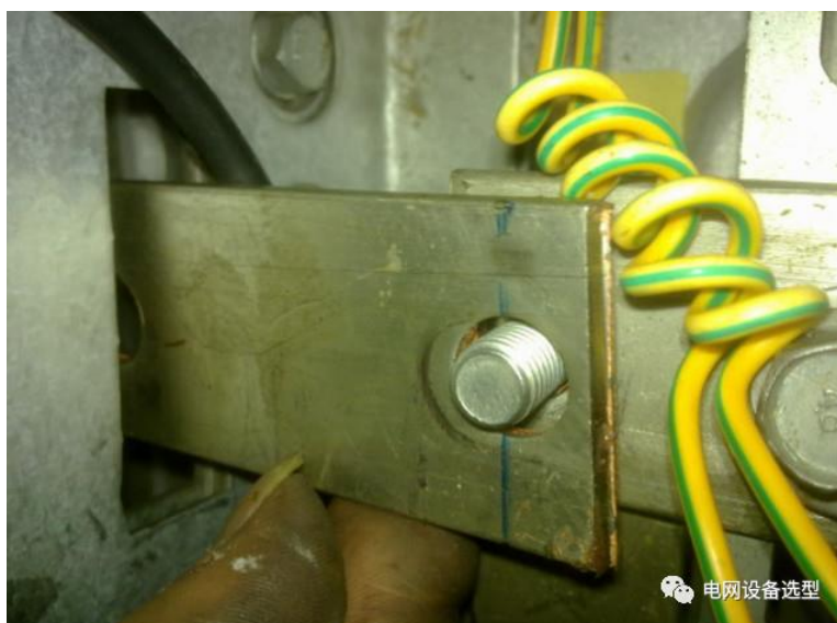
图十：这个就是接地排，在高压柜的后柜门最下面。
