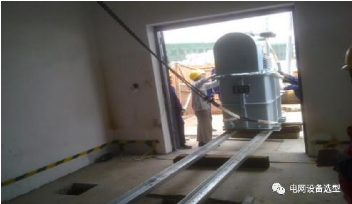
图二：将设备平移进室内，室内使用的是链条葫芦二、高压开关柜就位及拼装
